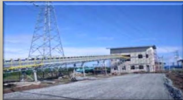
MUKAH POWER PLANT, SARAWAK
