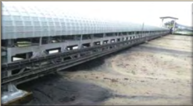
MUKAH POWER PLANT, SARAWAK
