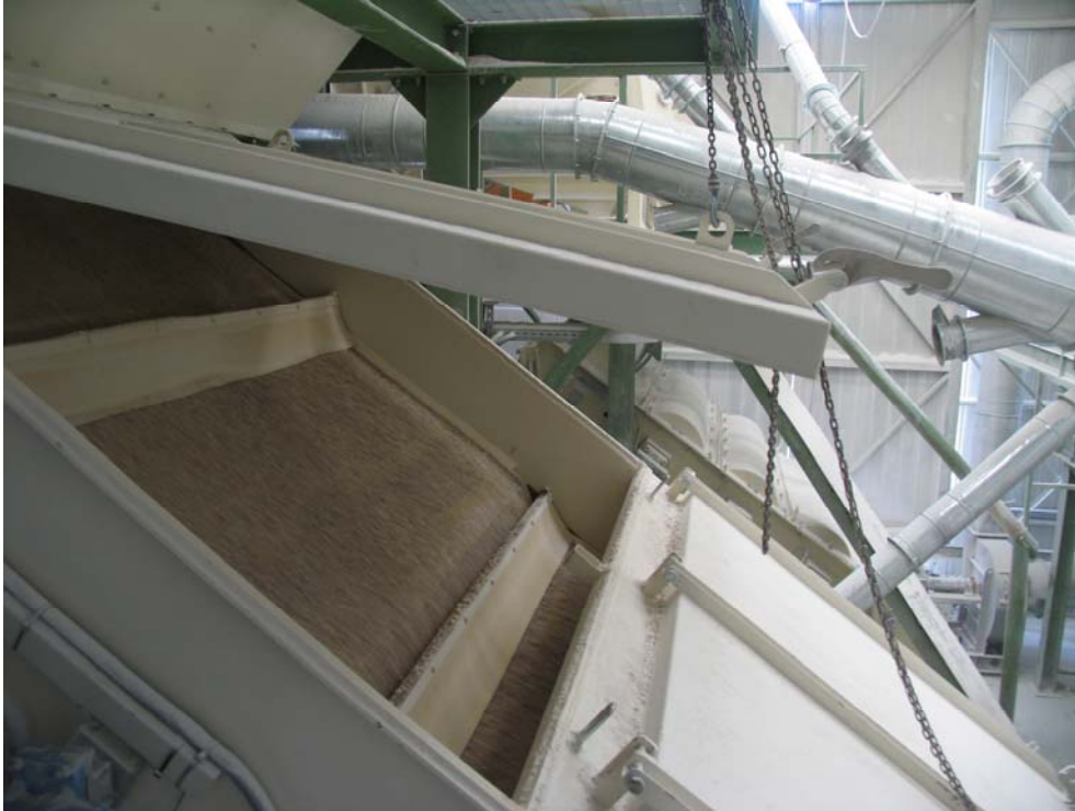
Bild 7: Vordergrund RHEWUM Siebmaschine im Betrieb, Hintergrund Mehrflächenklassiersieb.
