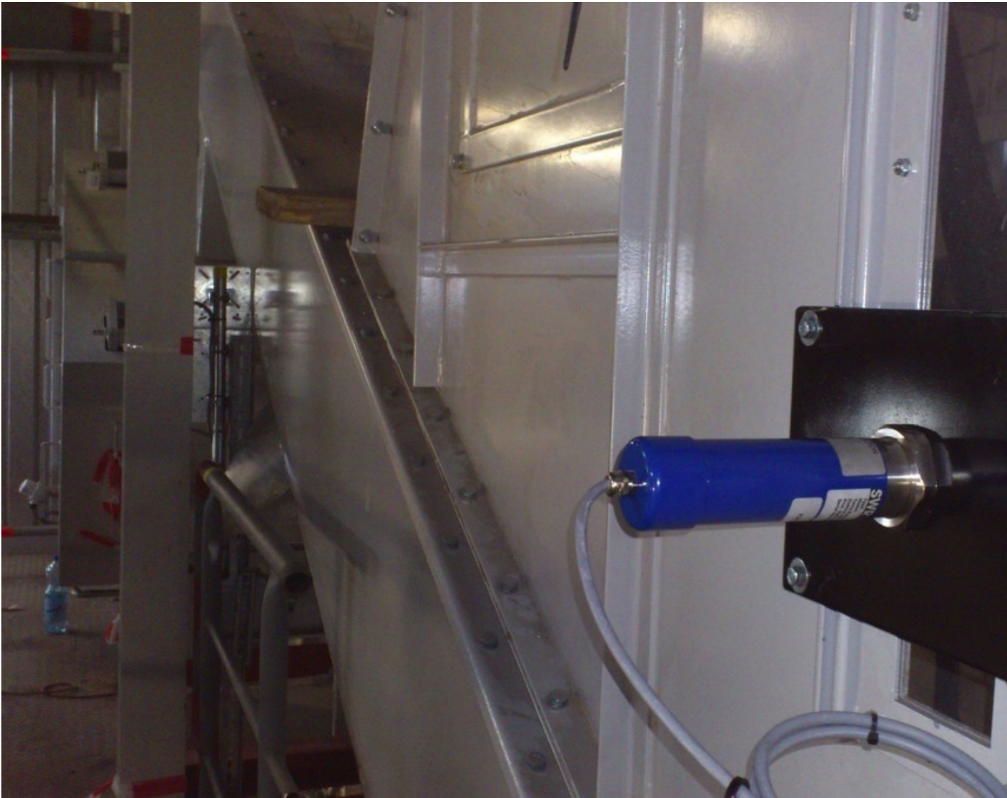
Füllstandsüberwachung mit einer ProGap Mikrowellenschanke. (Bild SWR engineering)
